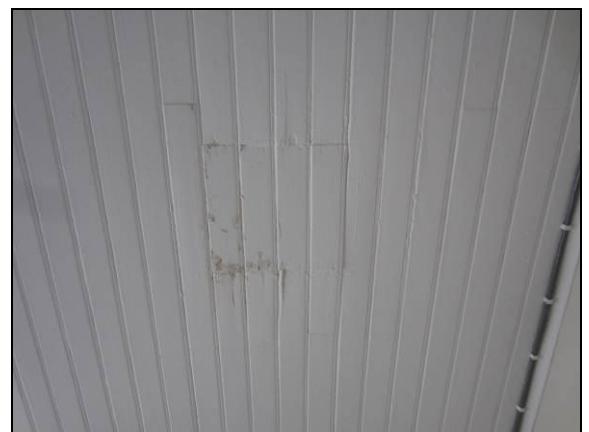
Kuva 34. Monistamotilan katossa on kosteusvauriojälki.
