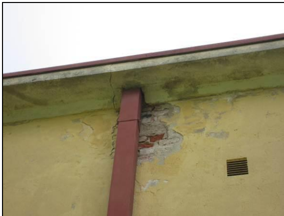
Kuva 15. Vaurioita seinien yläosissa ja syöksyjen kohdilla.
