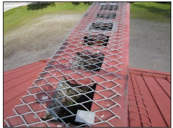
Kuva 44. Painovoimaisen ilmanvaihdon hormeja.
