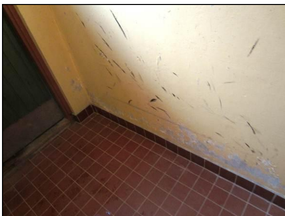
Kuva 37. Yleiskuva, lisärakennuksen wc-tiloissa on pintarakenteissa vaurioita.
