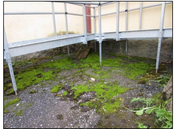
Kuva 4. Sisäänkäynnin edustan asfaltointi on heikokuntoinen.
