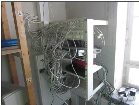
Kuva 56. Yleiskaapelijakamo ja antennivahvistin.
