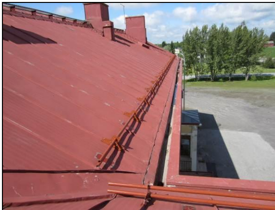
Kuva 27. Vesi jaa hieman makaamaan räystäskouruun.
