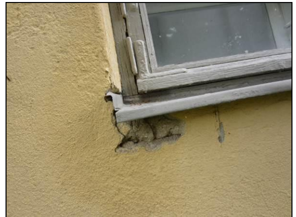
Kuva 16. Vaurioita ikkunapeltien alapuolella.
