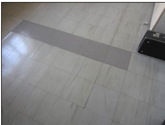
Kuva 35. Luokkatilojen lattiapinnat alkavat olla käyttöikänsä lopussa.
