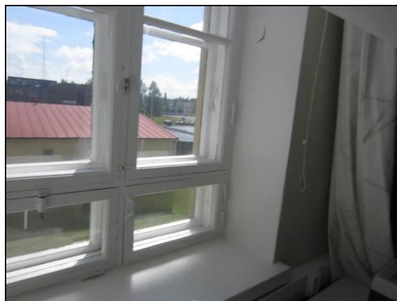
Kuva 36. Osassa tiloista ikkunapielissä maali hilseilee hieman irti.
